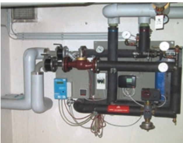
Die Komponenten einer Fernwärmeübergabestation Foto: Geschäftsstelle für Energiewirtschaft
